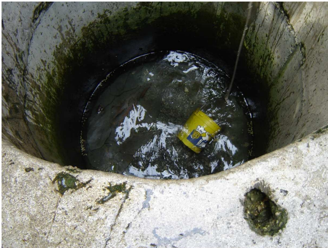
Vista del interior del pozo del que se extrae el agua para la población.
